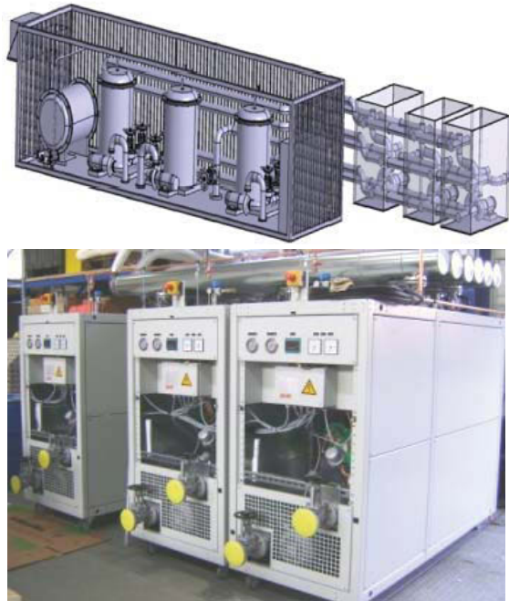
Abb. 7: Temperiermischanlage zur beschleunigten Aufheizung/Abkühlung von Vorrichtungen im FAST-RTM-Verfahren, Gesamtansicht (oben) u. Mischanlage (unten)
