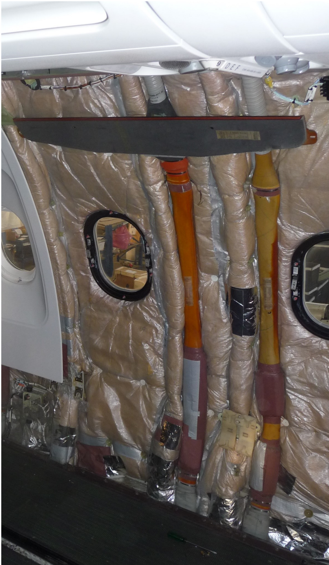
Bild 4.2 Klimarohre kommen nach Ausbau der Sitze und Kabinenverkleidung zum Vorschein (Scholz 2021)
